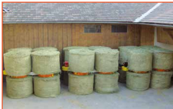
3 Belüftungsmodule für 24 Rundballen
